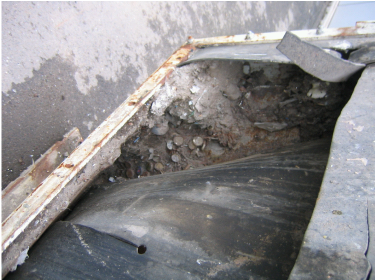
Abbildung 10: Ablagerungen in einem Gurtförderer
